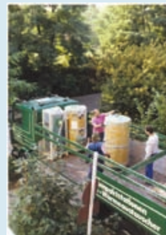
Material für die neuen Hausanschlussstationen
